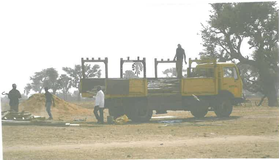
Material für Trinkwasser- Anlage
